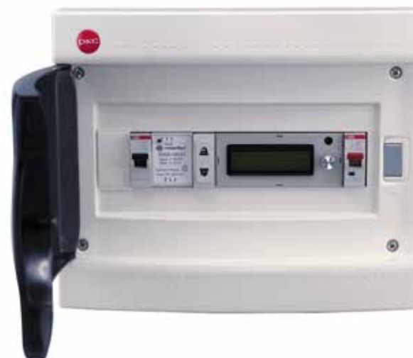
Рисунок 4. Шкаф управления внутренним освещением
