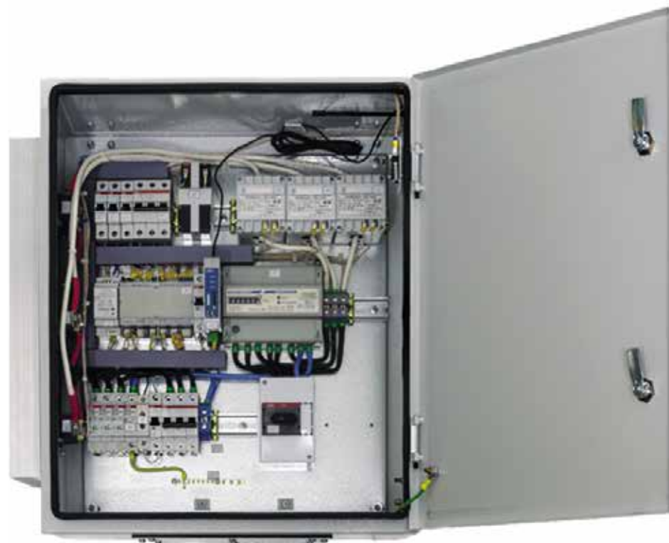
Рисунок 3. Шкаф управления наружным освещением
